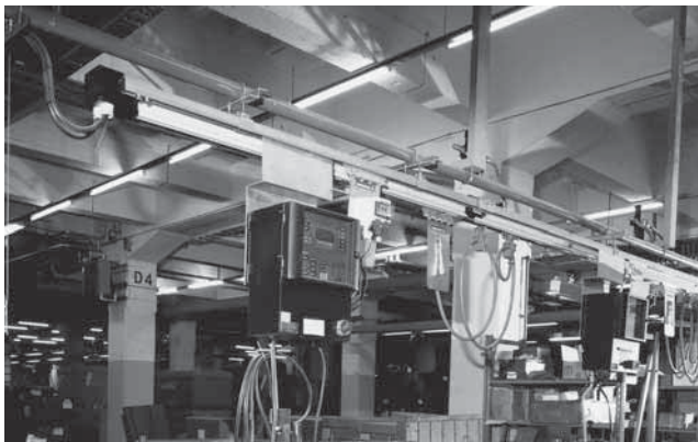
KTW-System in einer Fertigungsanlage
